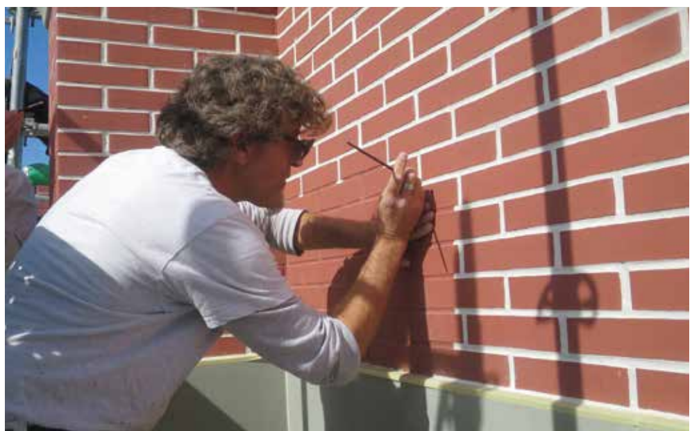
De haut en bas: réalisation de l'extension au sud; pose des balconnets en bois entièrement refaits; mise en peinture des briques avec leurs joints.
